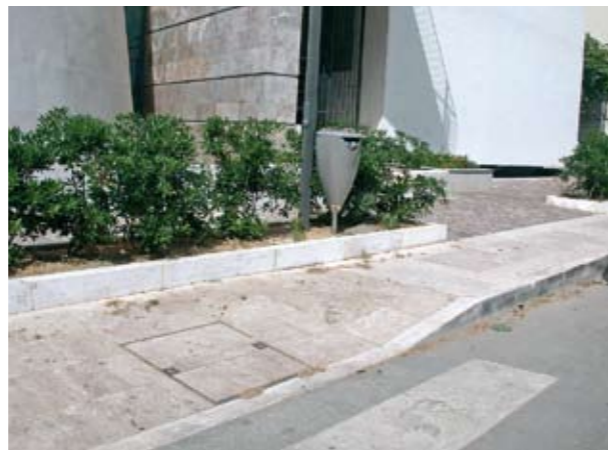
Rampa mal collegata con il marciapiede e priva di indicazioni tattili sul piano di calpestio.
