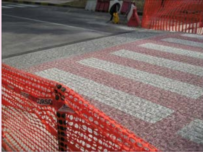
FOTO 11. Un passaggio pedonale rialzato usato come rallentatore di velocità. Purtroppo, la grande ruvidità dei cubetti è fuori norma (oltre 2mm max sulle creste) che innesca vibrazioni fastidiose alle sedie a rotelle. Un “sentiero” di 1,5 m liscio ed asfaltato sarebbe stato un perfetto corridoio di guida per gli ipovedenti e per le sedie a rotelle.
